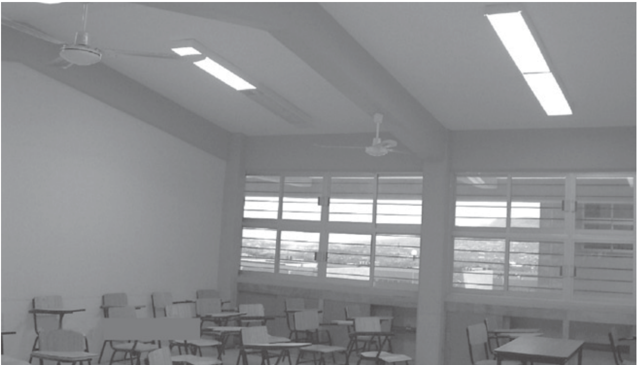
En esta fotografía se puede apreciar el desperdicio de energía eléctrica tanto en lámparas como en ventiladores.
